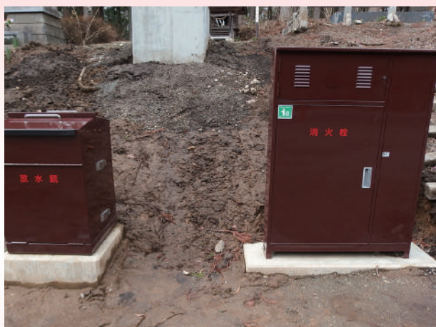
放水銃と消火栓
