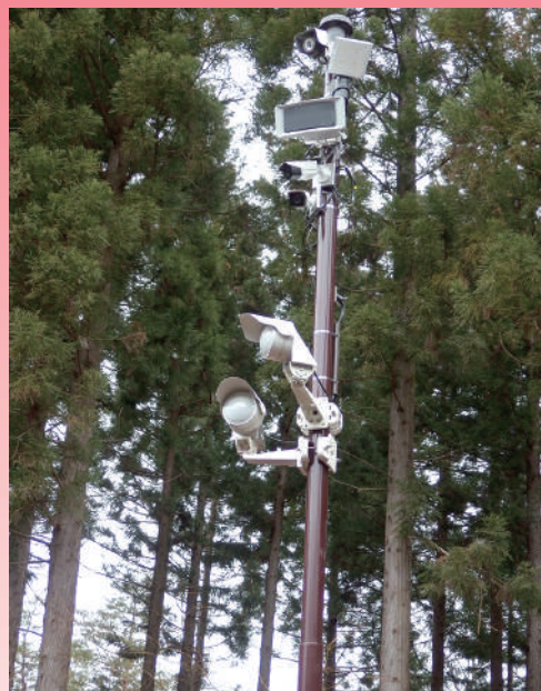
監視カメラ・人感センサー・照明・スピーカー
