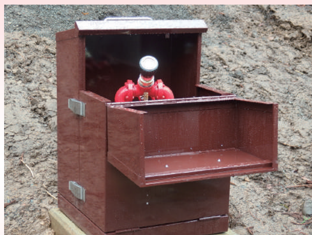
フタ開放状態の放水銃
